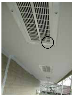
軒天換気口 微差圧計
