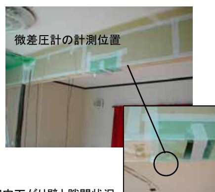
室内下がり壁と隙間状況
