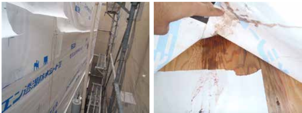
通気層の防風シート重ね継手の押え不備と縦通気胴縁取付部の撥水性失効に因る浸透湿潤。
