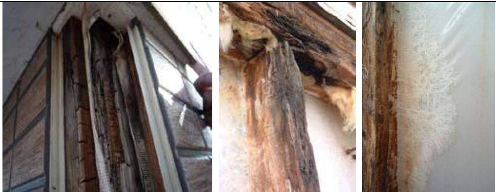
通気層上部が閉塞し腐朽が進行した。 防風シート下端の捲れにより壁体内が結露し激しく腐朽。
