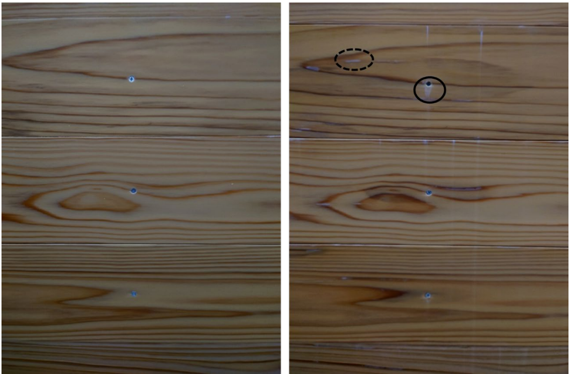
写真8 試験体 C の促進劣化前（左）と促進劣化後（右）の外観 右側写真の実線楕円内は釘打ち箇所から難燃薬剤と思われる白色物質が出現，破線楕円内は塗膜の微小割れから白色物質の出現を示す。
