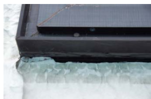
建築年数：築 11 年 建設地：茨城県 透湿防水シートメーカーが推奨していない防水テープを使用
