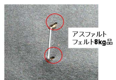
アスファルトフェルト8kg品 寸法安定性の不足による釘孔の拡大(施工直後)
