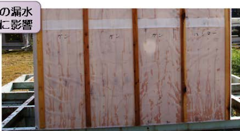
透湿防水シート、風速5m/s、4分間撒水後 写真-1 釘孔と漏水
