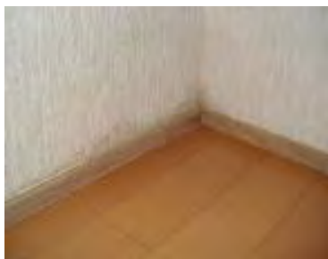
写真11 写真10の間仕切り壁の室内側の様子。壁下部に結露によると思われる浸み痕がある。
