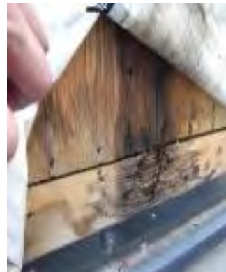
写真9 通気層内への雨水侵入による合板の腐朽
