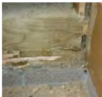
写真 14 框受け土台下部の腐朽被害例
