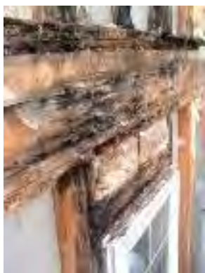
写真7 通気層内への雨水侵入による躯体の腐朽
