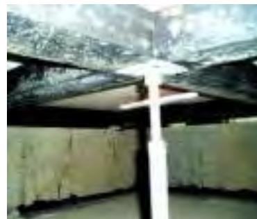
写真3 工事中における床下湿潤によるカビの発錆
