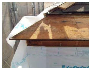
軒先広小舞合板の湿潤と腐朽
