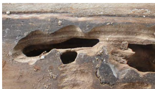
写真 7 筋交表面の穿孔被害
