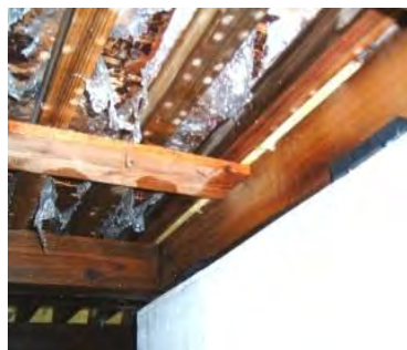
写真2 床下地板の結露とカビ
