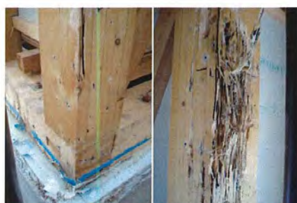
集成柱の被害状況（左：土台と柱の接合部分、右：上部）
