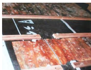
野地板と防水層間の結露・カビ
