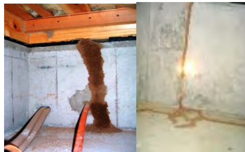
写真5 コンクリート打設時に立ち上がり部型枠を固定するための金具の隙間から侵入した例
