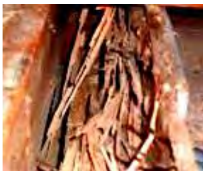
写真 15 玄関框下部のシロアリ被害例
