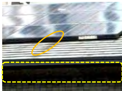
軒天井と外壁上部の結露湿潤
