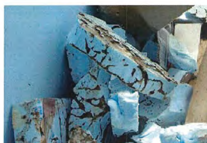
断熱材に構築された蟻道
