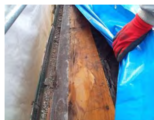
軒先野地板の湿潤による腐朽
