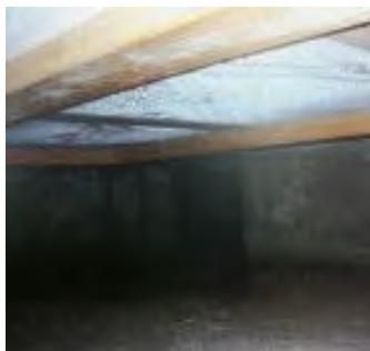
写真1 換気口が閉塞状態で床下にカビと結露が発生
