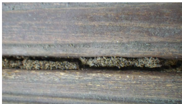
写真 8a, b 内装扉部分のアリの「蟻道」
