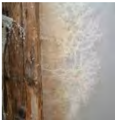
写真8 通気層内への雨水侵入によって発生した腐朽菌菌糸
