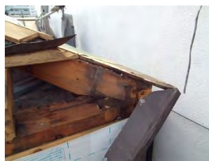
垂木先端と軒桁天端の腐朽
