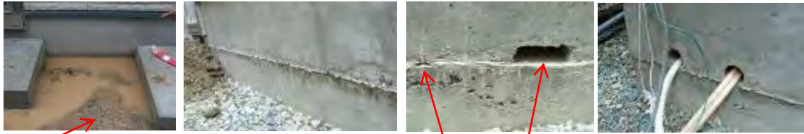
整地不良による排水不順 通常の基礎立上り部の打継状態 型枠金物と水抜き穴の状態 基礎外周を貫通する設備配管
