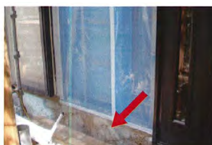
基礎部分の蟻道
