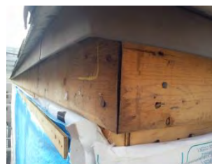
垂木先に取付けた鼻板の湿潤
