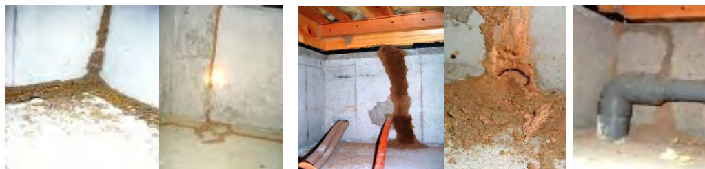
基礎打継部型枠用巾止金具からの侵入蟻道
